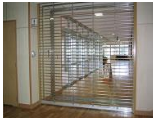
図 3-4 教室部分と開放部分を遮断するシャッター
