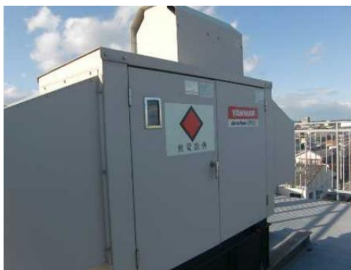
図 3-1 浸水対策として屋上に設置されている非常用発電設備
