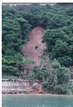
写真-4 平成30年7月豪雨による被害 県道16号線（王越町）
