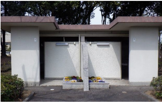
老朽化したトイレ
