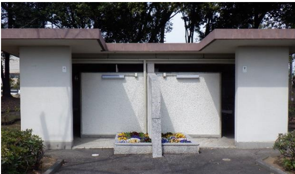
老朽化したトイレ
