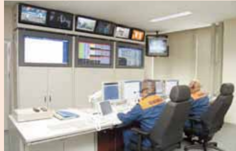
● 坂出消防署 システム指令室
