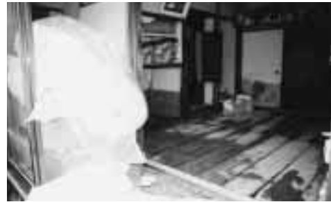
▲床上浸水した家屋。畳は海水に浸かり、ふすまには海水の深さを示す跡が。護岸を越えた海水は腰の高さまでであったという。(王越町)
